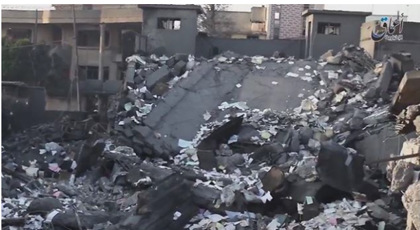
(Foto: Budynki ISIS po nalocie)
